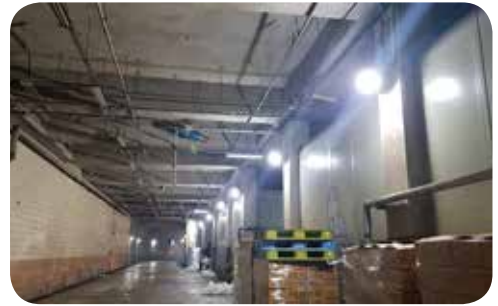
설치장소 강서 농수산물 도매시장 화물주차장 설치제품 IH2-80S-57K
