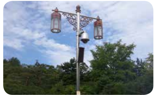
설치장소 월미도 내 월미공원 보안등 설치제품 OBB-60S L+ -5700K
