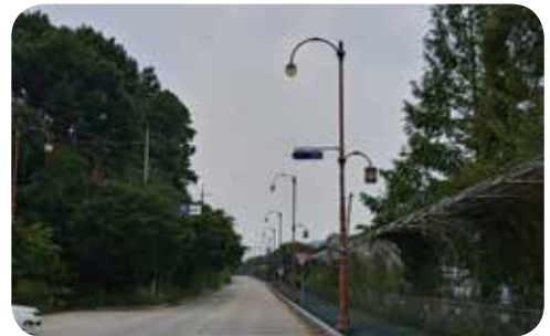
설치장소 아산 신정호 가로등 설치제품 OB230-100W-3000K
