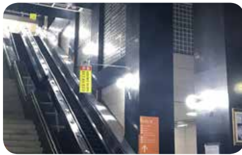
설치장소 지하철 인천시청역 설치제품 IB2-30CS
