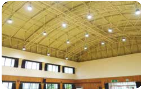
설치장소 인천 소재 초등학교 체육관 설치제품 KH22-150S-57K
