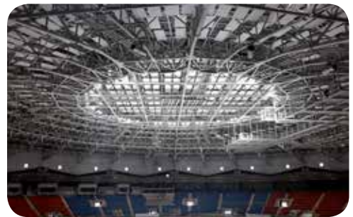
설치장소 올림픽 체조 경기장 설치제품 ITCA-800
