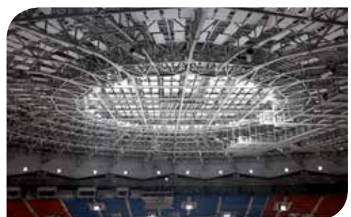
설치장소 올림픽 체조 경기장 설치제품 ITCA-800
