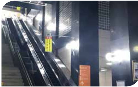
설치장소 지하철 인천시청역 설치제품 IB2-30CS
