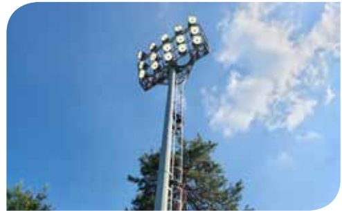
설치장소 괴산 청소년수련원 축구장 설치제품 CT8000S-700W-B3-A-P
