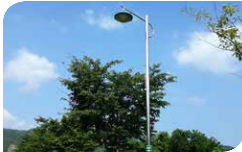
설치장소 전남 장흥군 장흥댐 설치제품 OB230c-100S-5700K
