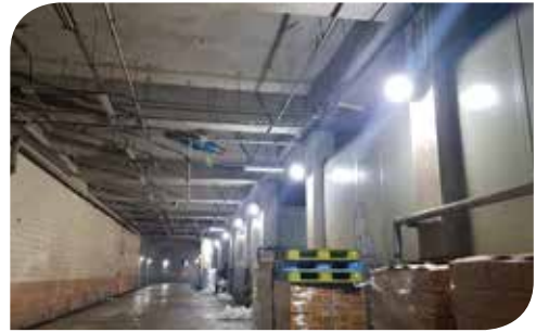
설치장소 강서 농수산물 도매시장 화물주차장 설치제품 IH2-80S-57K
