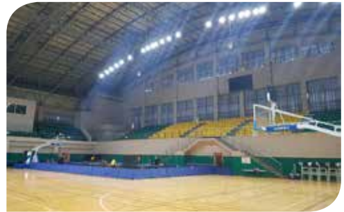
설치장소 안산시 와동체육관 설치제품 CD3000-150W-B2-P
