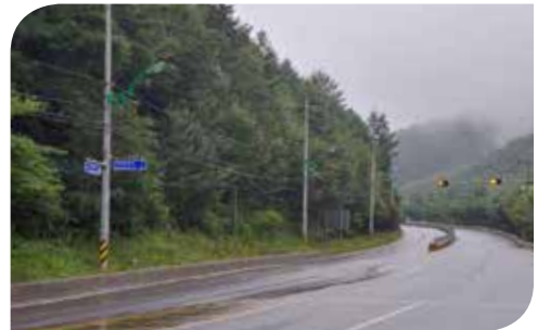
설치장소 강원 태백시 가로등 설치제품 OB230c-100S-5700K
