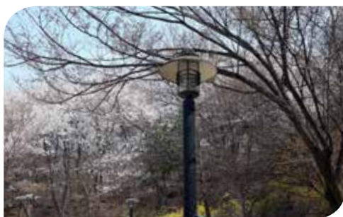
설치장소 금천구청 금천체육공원 설치제품 OBB-60S L+-5700K
