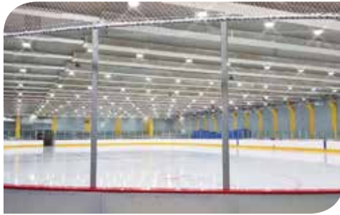
설치장소 고양도시관리공사 실내빙상장 설치제품 IH2-80S-57K
