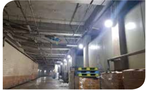
설치장소 강서 농수산물 도매시장 화물주차장 설치제품 IH2-80S-57K
