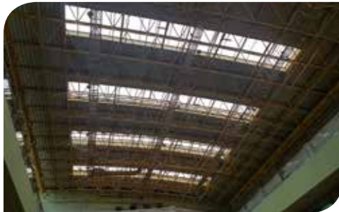
설치장소 금천구민문화체육센터 실내체육관 설치제품 IH2-100S-57K
