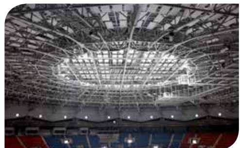
설치장소 올림픽 체조 경기장 설치제품 ITCA-800
