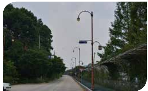
설치장소 아산 신정호 가로등 설치제품 OB230-100W-3000K
