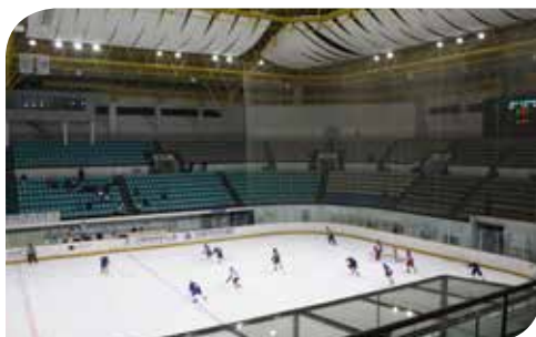
설치장소 목동 아이스링크 설치제품 ITCA-800
