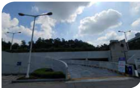
설치장소 고양문화재단 가로등 설치제품 OBB-80S L+ -5700K
