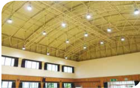
설치장소 인천 소재 초등학교 체육관 설치제품 KH22-150S-57K
