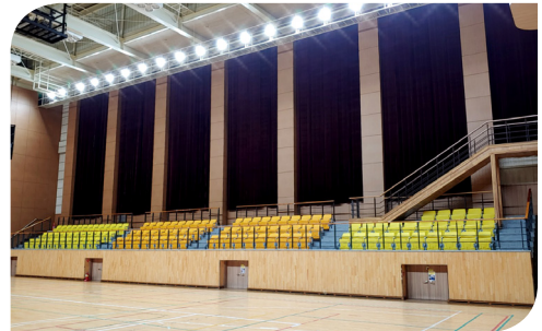
설치장소 장수군 시설관리사업소 다목적 체육관 설치제품 IH2-100S-57K
