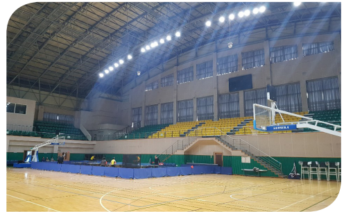
설치장소 안산시 와동체육관 설치제품 CD3000-150W-B2-P
