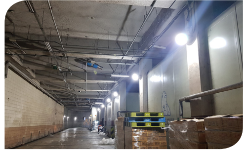
설치장소 강서 농수산물 도매시장 화물주차장 설치제품 IH2-80S-57K
