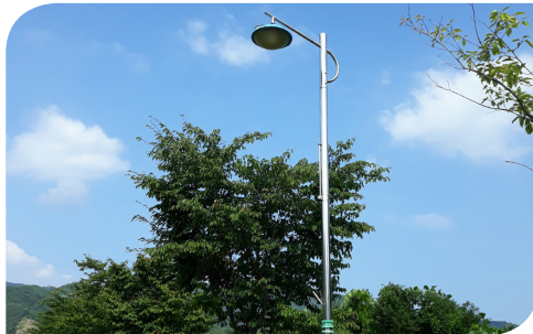
설치장소 전남 장흥군 장흥댐 설치제품 OB230c-100S-5700K
