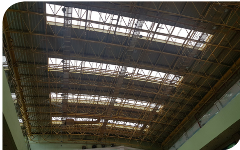
설치장소 금천구민문화체육센터 실내체육관 설치제품 IH2-100S-57K
