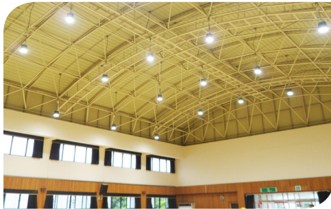
설치장소 인천 소재 초등학교 체육관 설치제품 KH22-150S-57K
