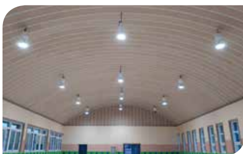
설치장소 경남 고성군 소재 초등학교 체육관 설치제품 IH2-100S-57K
