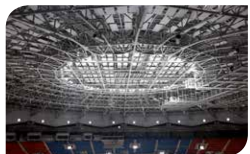
설치장소 올림픽 체조 경기장 설치제품 ITCA-800
