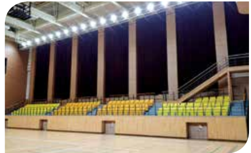
설치장소 장수군 시설관리사업소 다목적 체육관 설치제품 IH2-100S-57K
