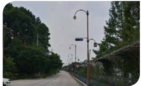
설치장소 아산 신정호 가로등 설치제품 OB230-100W-3000K
