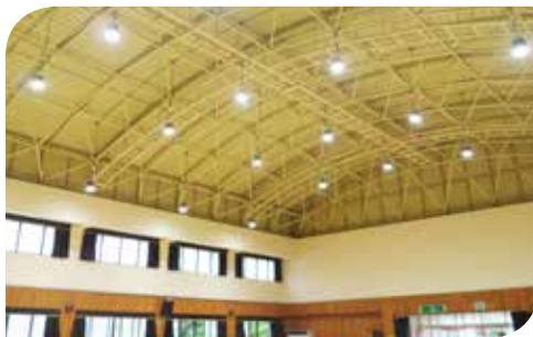
설치장소 인천 소재 초등학교 체육관 설치제품 KH22-150S-57K
