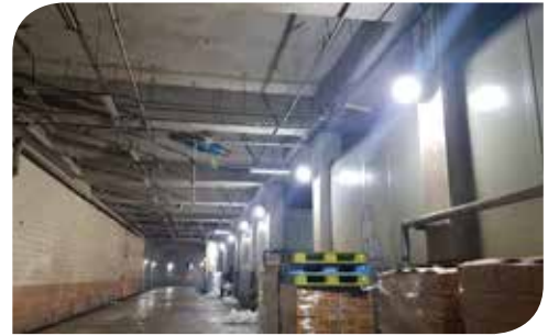
설치장소 강서 농수산물 도매시장 화물주차장 설치제품 IH2-80S-57K
