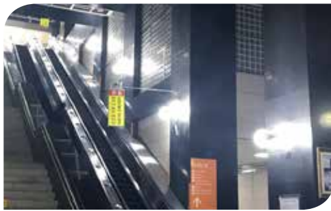
설치장소 지하철 인천시청역 설치제품 IB2-30CS
