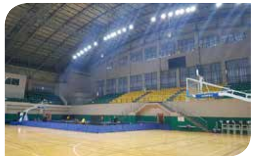
설치장소 안산시 와동체육관 설치제품 CD3000-150W-B2-P
