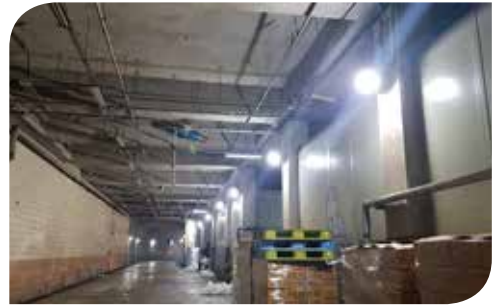
설치장소 강서 농수산물 도매시장 화물주차장 설치제품 IH2-80S-57K
