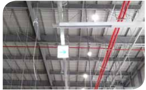
설치장소 대전 광역 우편 물류센터 설치제품 CH2000-130W L+ -A1-P
